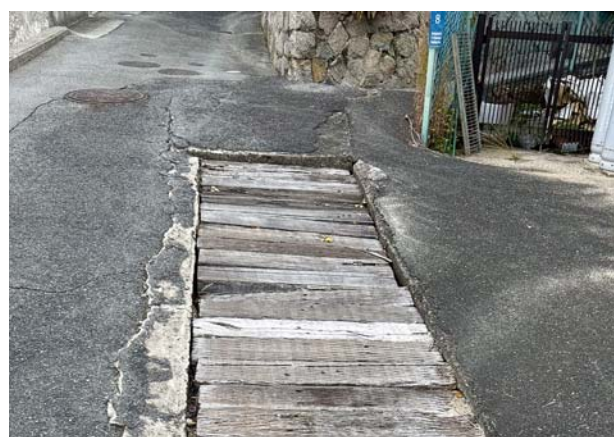
老朽化した枕木
