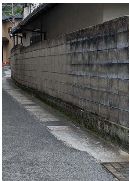
耐震化が望まれるブロック塀
