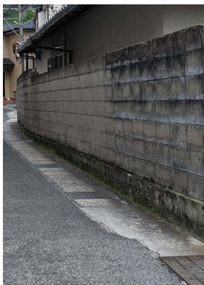
耐震化が望まれるブロック塀
