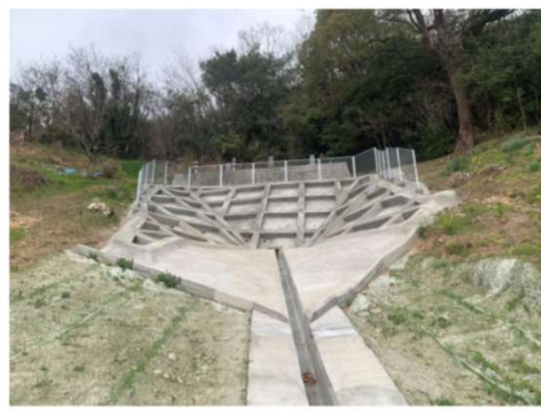
▲田島地区急傾斜地崩壊対策工事 急傾斜地崩壊対策の工事が完了しました。
