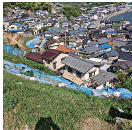
工事が待たれる急傾斜地
