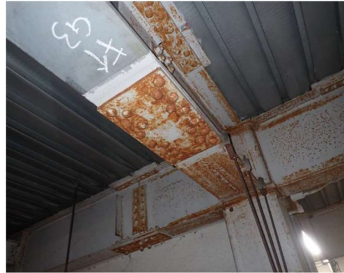
主桁の防食機能の劣化
