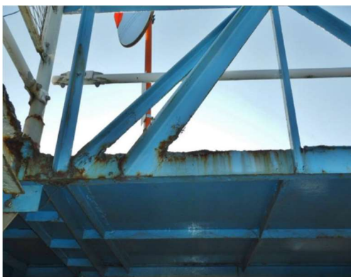
横桁・縦桁等の腐食
