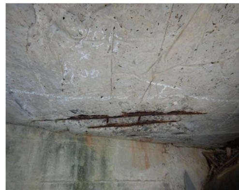
コンクリート床板の鉄筋露出
