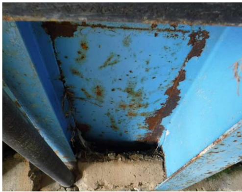
鋼床版の腐食・防食機能の劣化
