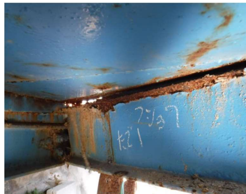
横桁・縦桁等の腐食
