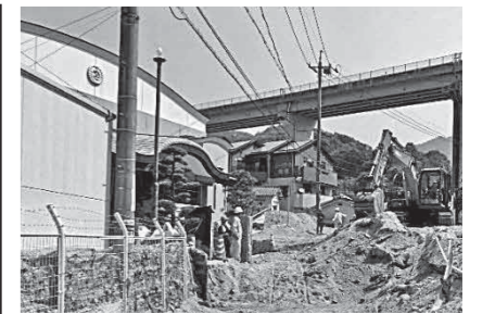
平成30年7月豪雨災害では1階が土砂に埋まる
