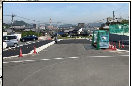
【1-2 工区】(中村地区) 荒神橋付近において、総頭川に向 け、用地買収させていただいた範囲 で工事を進めています。
