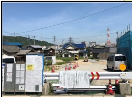
【1-1 工区】(森浜地区) 現在供用されている県道から 北側に向け工事に着手しています。
