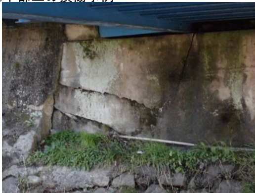
橋台のひび割れ・破断
