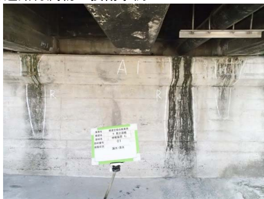
伸縮装置からの漏水
