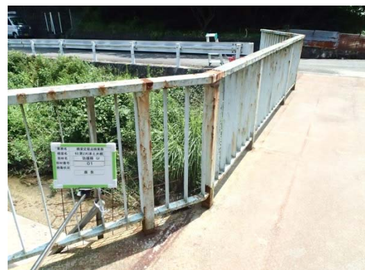
高欄の防食機能の劣化
