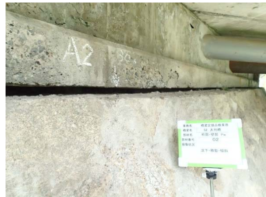
橋台の護岸基礎の沈下
