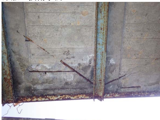
床版の剥離・鉄筋露出
