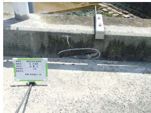
コンクリート地覆の剥離・鉄筋露出
