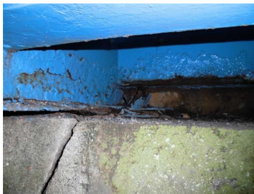
鋼製支承の腐食
