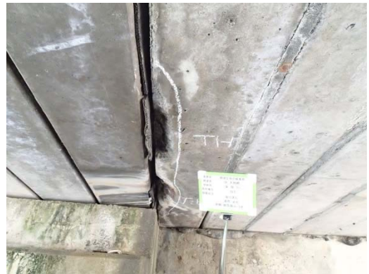
P C橋の剥離・鉄筋露出
