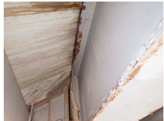
床版の漏水・遊離石灰
