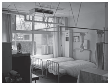
保健室に設置されたエアコン
